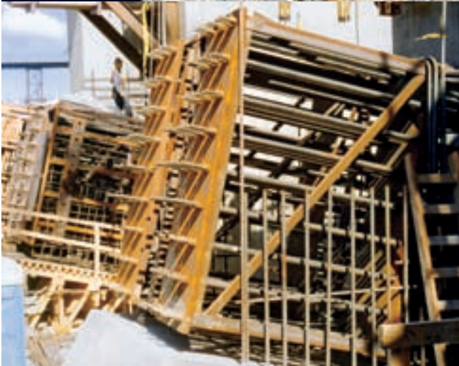
Centrale idroelettrica Grand-Mère, Canada
